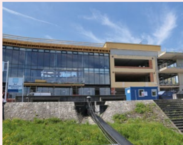
Stadthalle donauseitige Ansicht. Weitere Fotos vom Baufortschritt finden Sie auf der letzten Seite dieser Ybbser Nachrichten.
